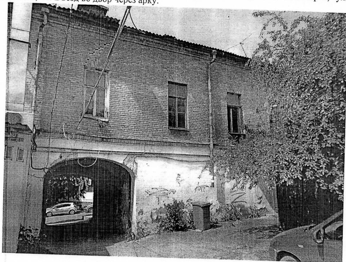
Фото 13. Объект культурного наследия регионального значения «Особняк», конец XIX в., расположен по адресу (местонахождение): Ставропольский край, г. Пятигорск, улица Дзержинского, 41. Фрагмент дворового фасада.
